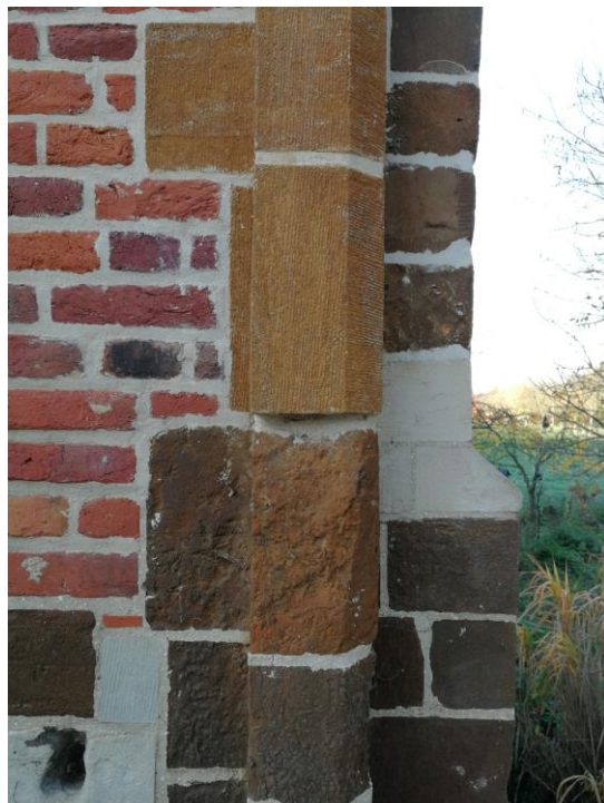
Carrstone (Norfolk) op Diestiaan Abdij Vlierbeek noorderpoort restauratie 2016
